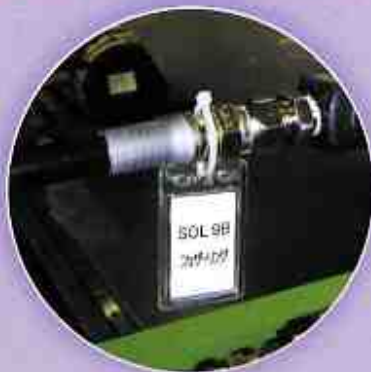
配管の識別に!!
